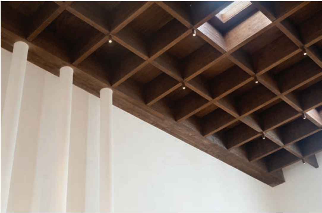
Per illuminare l'aula centrale, apparecchi cilindrici a LED sono montati a soffitto nei punti d'intersezione fra le travi lignee.
